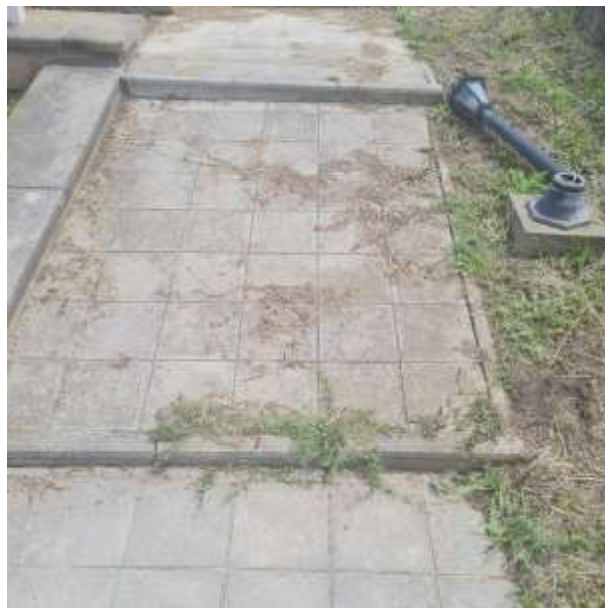
Fig.8 Lămpile de iluminat exterior
